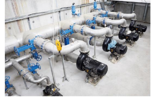
Atık su arıtma tesisi
